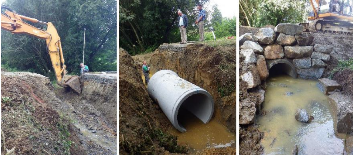
Figure 50: Exemple de travaux de remplacement de buse réalisé par la FDAAPPMA22 (Photos : © FDAAPPMA22)
