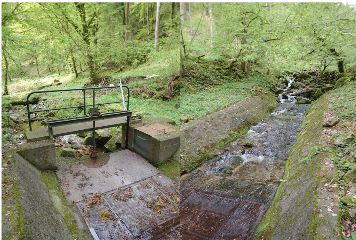
Figure 18: Photographies de la station de captage d'eau potable sur le Wissbach
