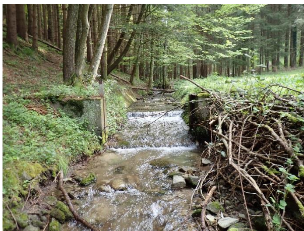
Figure 55: Exemple d'ouvrages sans usage ou délabré
