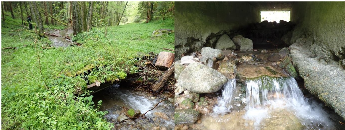
Figure 56: Exemple de pont et passerelle délabrés
